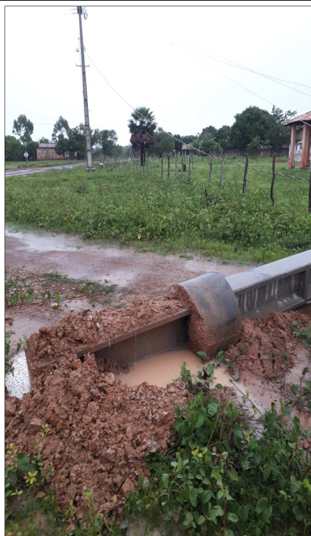
Foto 6 – Poste abalroado devido erosão do solo.
