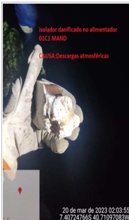
Foto 3 – Isolador danificado por descarga atmosférica.
