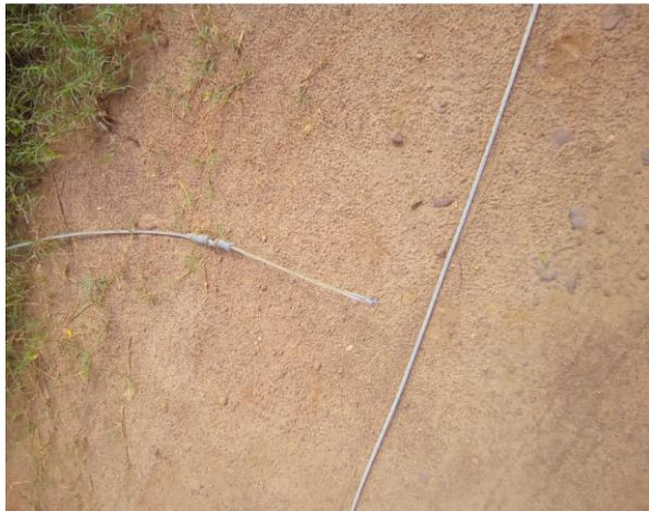
Foto – Cabo partido. Local: Pau d'arco. Regional: Metropolitana. Data: 07/02/2023
