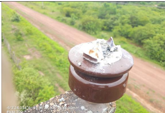
Foto – Isolador quebrado. Local: Nazária. Regional: Metropolitana. Data: 07/02/2023
