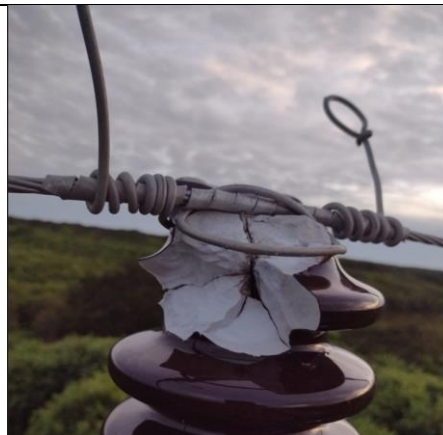
Foto – Isolador quebrado. Local: Nazária. Regional: Metropolitana. Data: 07/02/2023
