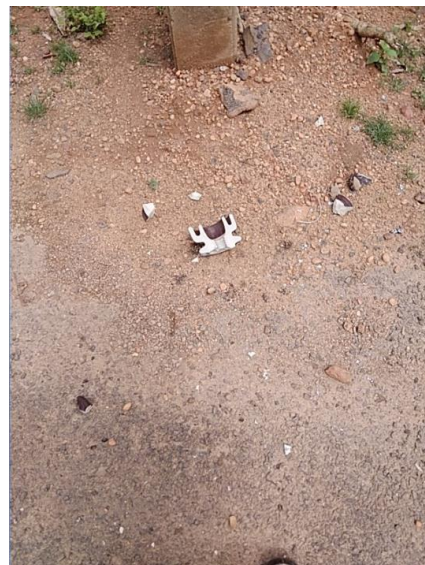
Foto – Isolador quebrado por descarga atmosférica. Local: Altos. Regional: Metropolitana. Data: 07/02/2023
