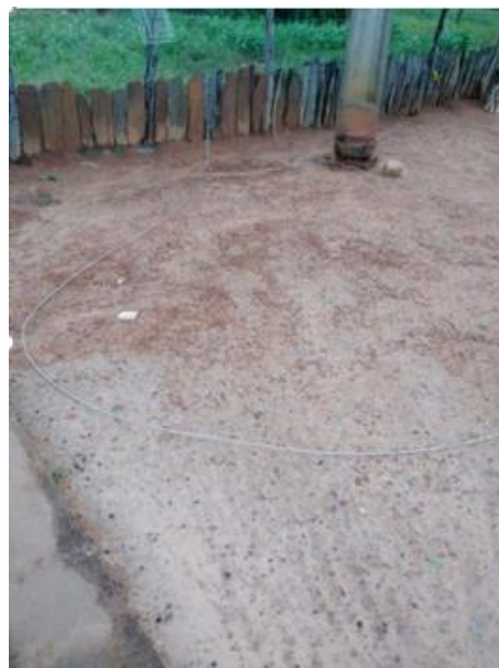
Foto – Cabo partido Local: Santa Cruz do Piauí. Regional: Sul. Data: 07/02/2023
