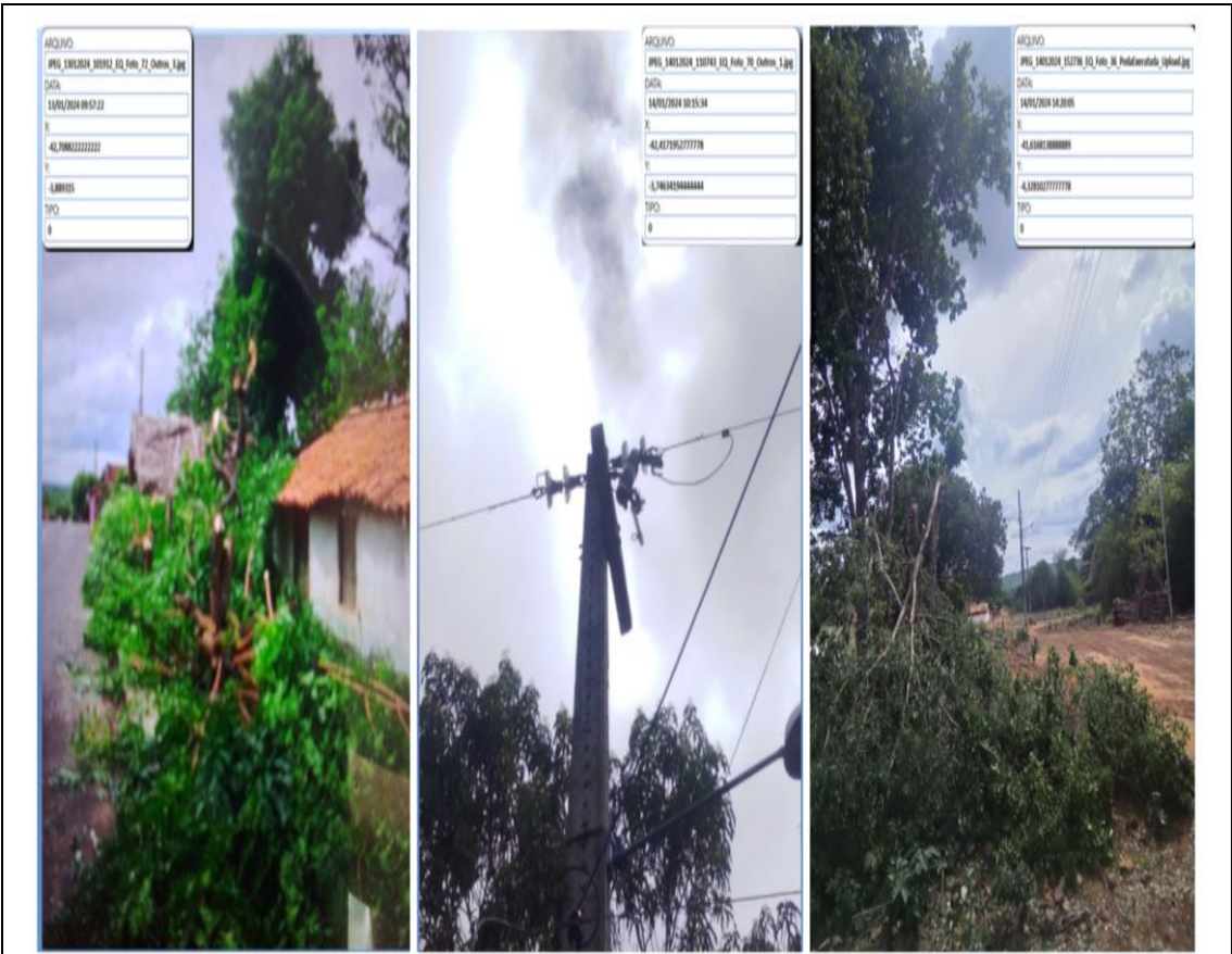
Fotos – Árvores na rede – Devido ventania, árvore de grande porte caiu sobre a rede, ocasionando o rompimento de condutores e danificando estrutura de sustentação de rede.
