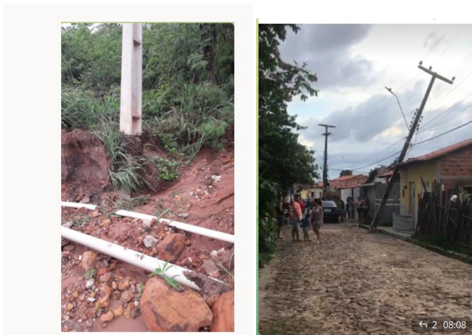
Erosão do terreno e tombamento do poste a jusantem bairro de teresina
