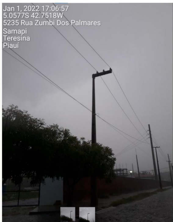
Rompimento de rede MT na fase B, rede impactada por descargas atmosféricas
