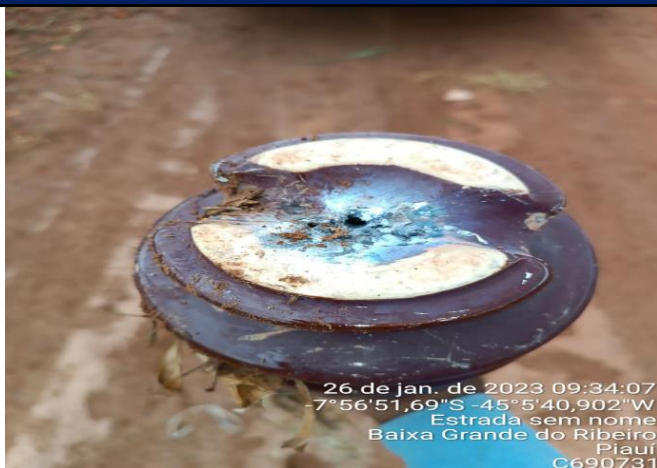
Foto – Isolador quebrado
