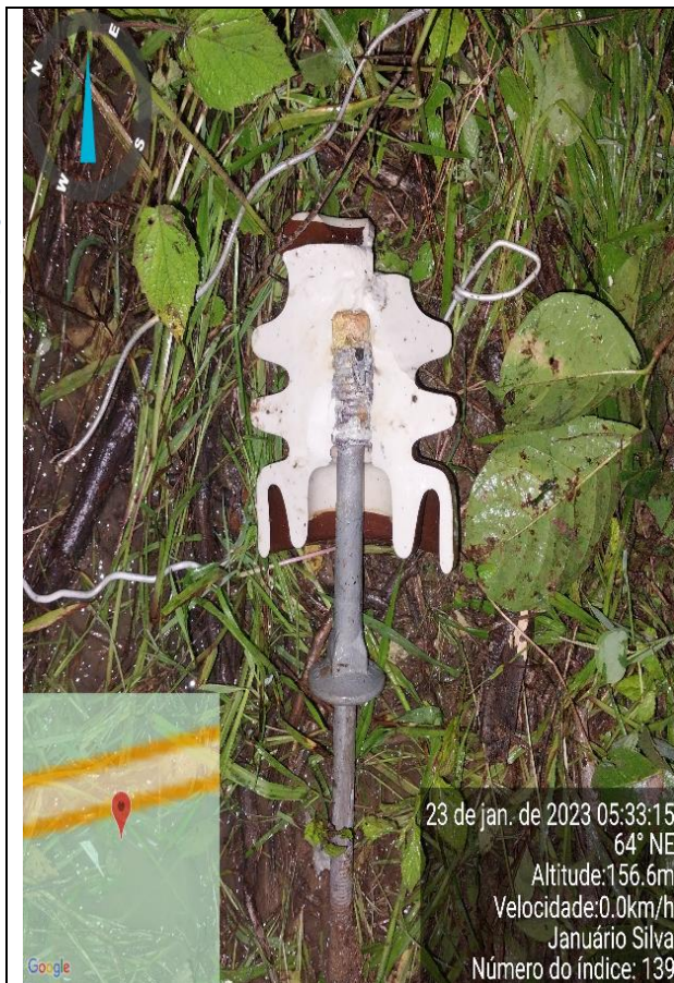
Foto – isolador danificado
