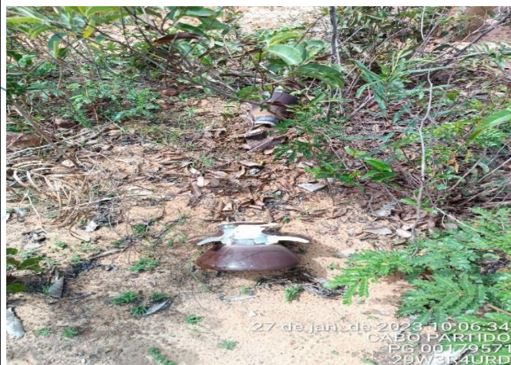
Foto – Isolador quebrado (descargas atmosféricas)
