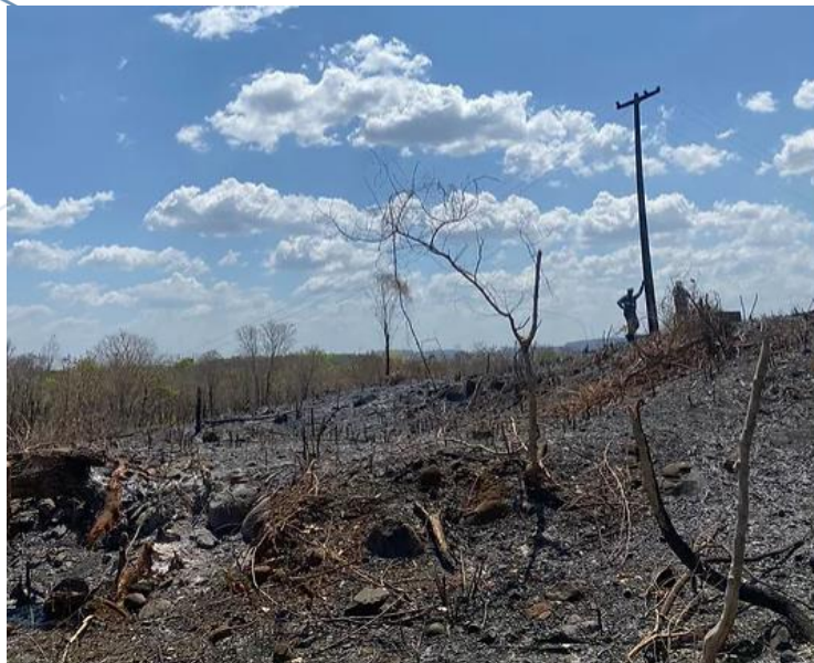
Foto – Detalhe do ponto do defeito. Regional: SUL Ocorrência: 22432. Data: 03/10/2024.
