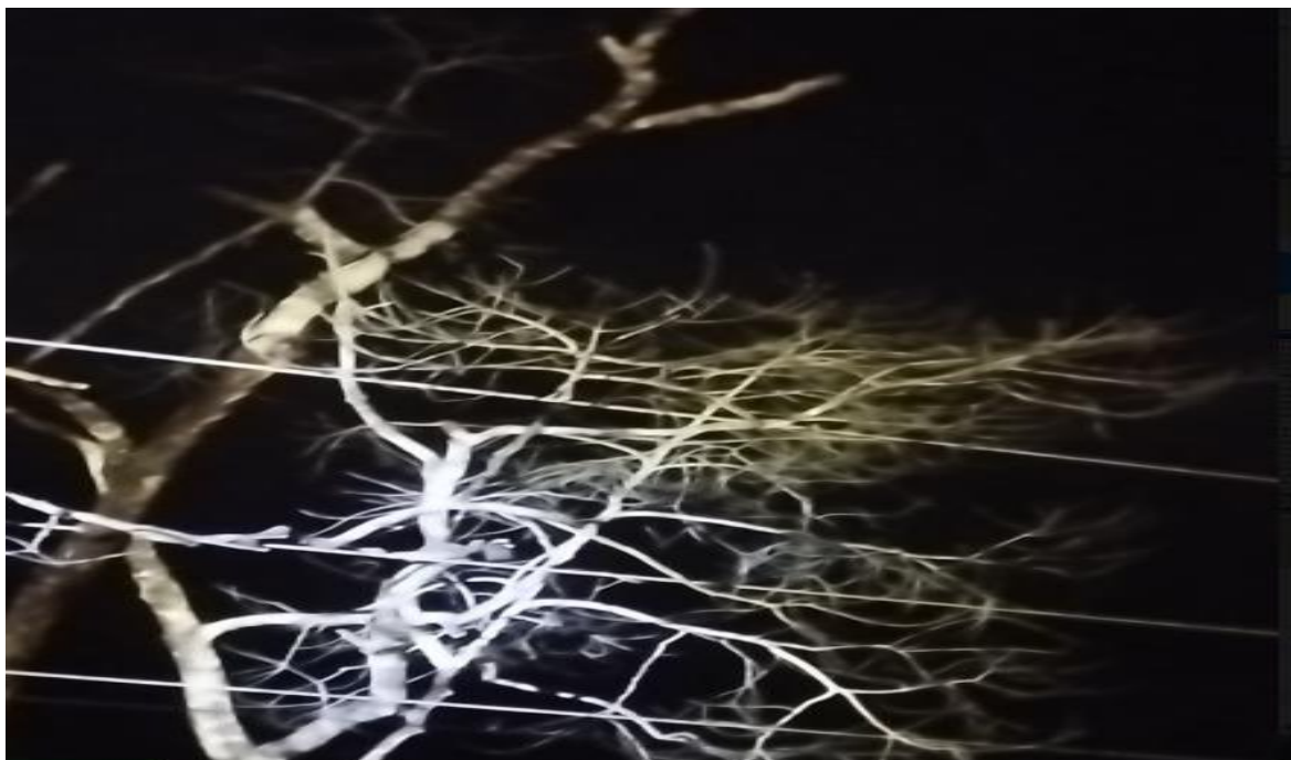
Foto – Galhos de árvore sobre a rede de Média tensão devido à chuva e ventania na região Local: União. Regional: Metropolitana Data: 20/05/2024.
