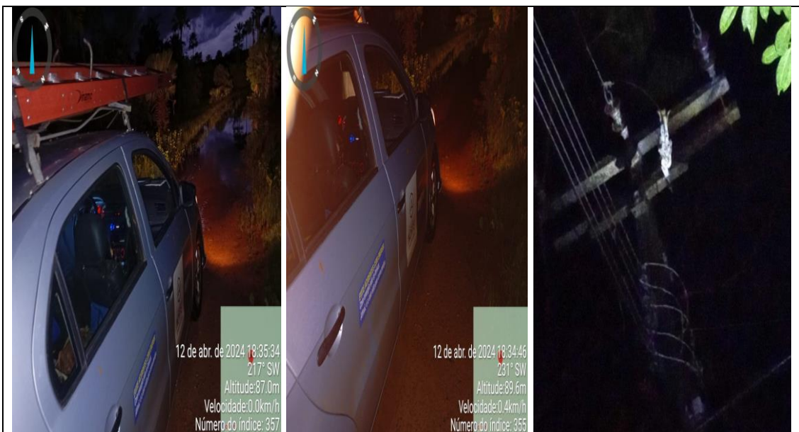
Foto – Árvore na Rede/ Alagamento - Durante o deslocamento para atender a uma ocorrência onde galho de árvore caiu sobre a rede, a equipe teve dificuldades chegar até o local do defeito, por conta de alagamentos na estrada. Município: Piripiri Regional: Norte Data: 12/04/2024 Ocorrência: 110333.
