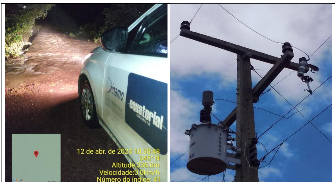
Foto – Árvore na Rede/ Alagamento - Curto provocado por árvore na rede devido chuva e ventania, a ocorrência foi atendida no dia seguinte, por conta de alagamentos na estrada que impossibilitaram o acesso da equipe ao local do defeito. Município: Piracuruca Regional: Norte Data: 12/04/2024 Ocorrência: 110588.
