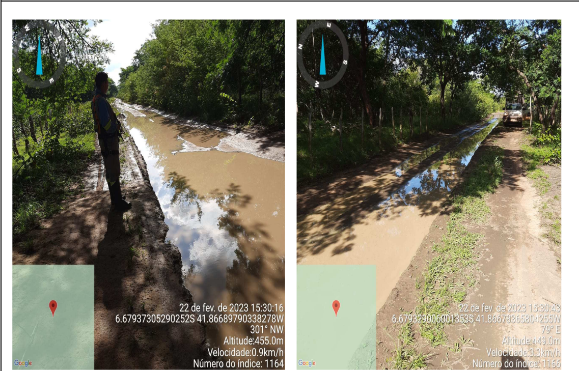
Foto –Áreas alagadas devido fortes chuvas.
