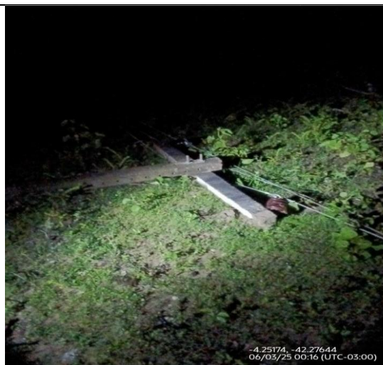
Foto – Ventania – Fortes ventos ocasionaram a quebra de galhos de árvore que, caíram sobre a rede ocasionando quebra de poste. Regional: Metropolitana Município: Barras Ocorrência: 38762-2025 Data: 06/03/2025.
