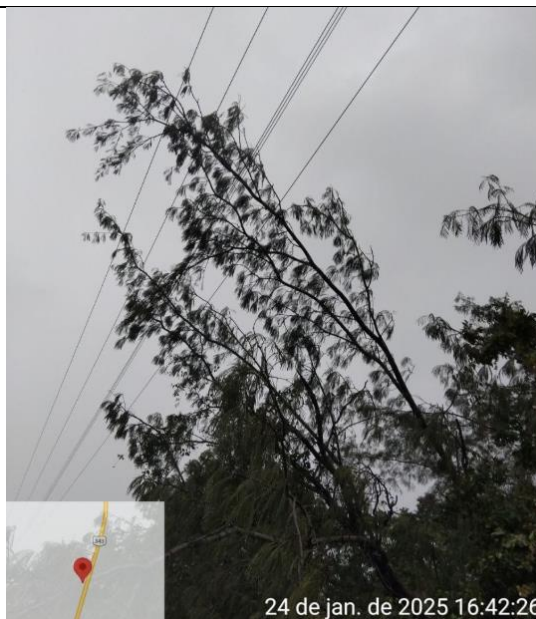
Foto – Ventania projetou de galhos de árvore que, tocaram a rede ocasionando interrupção. Município: Esperantina Regional: Norte Data: 25/01/2025.
