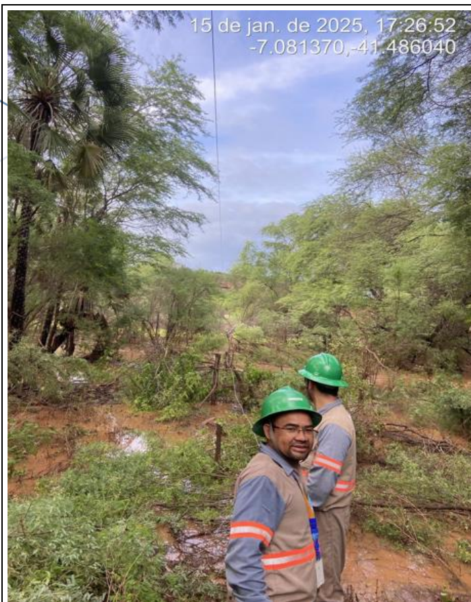
Foto – Detalhe do ponto do defeito – difícil cesso. Regional: Sul. Data: 15/01/2025.
