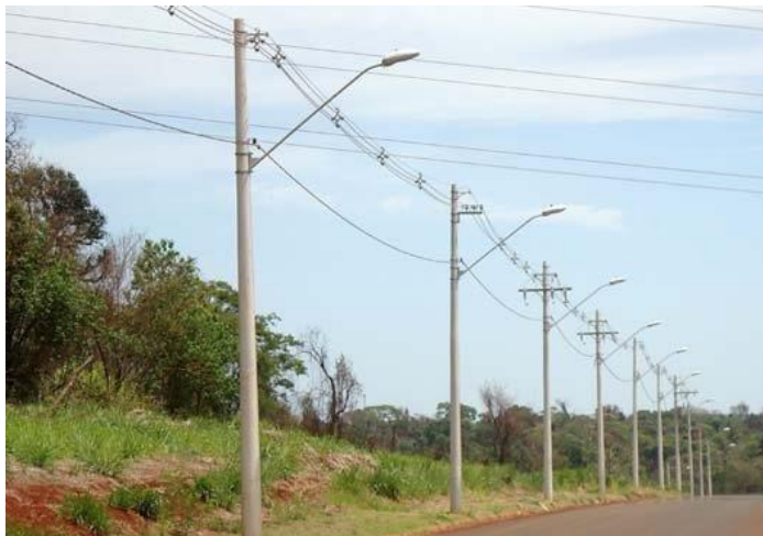
Figura 1 – Foto de Rede de Distribuição Compacta.
