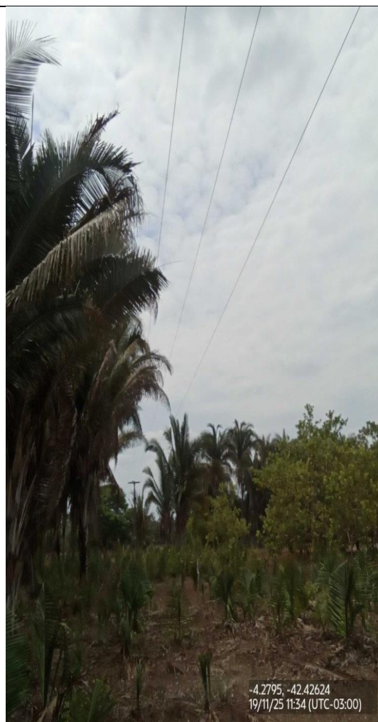
Foto – Ventania – Fortes ventos ocasionaram a quebra de galhos de árvore que, caíram sobre a rede ocasionando quebra de condutores. Regional: Metropolitana Município: Barras Ocorrência: 1491252025 Data: 19/11/2025.
