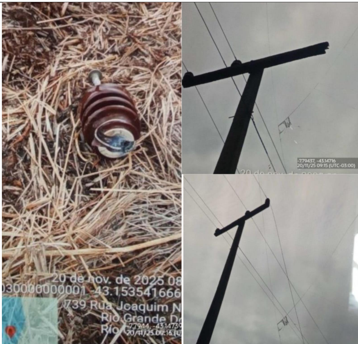
Foto – Descargas atmosférica - Houve muitas descargas atmosféricas que causaram danos a rede elétrica Regional: Floriano Data: 20/11/2025
