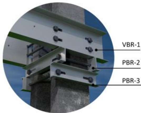
Instalação em Bancos de Reguladores
