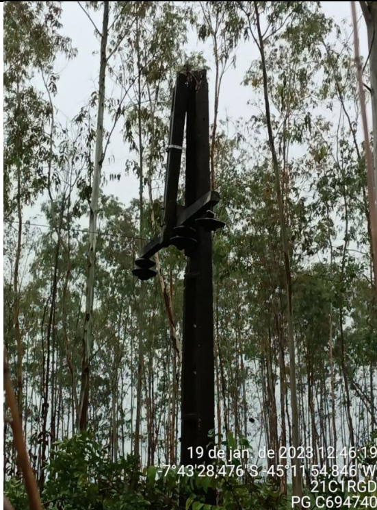
Foto – Cruzeta e Isolador quebrado
