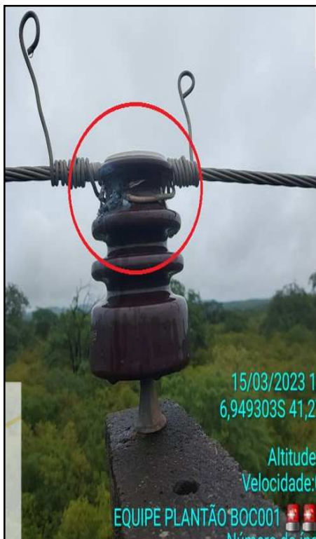
Foto 3 – Isolador danificado por descarga atmosférica.
