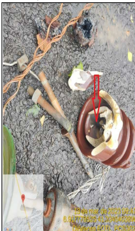
Foto 7 – Isolador danificado por descarga atmosférica, conforme indicado.
