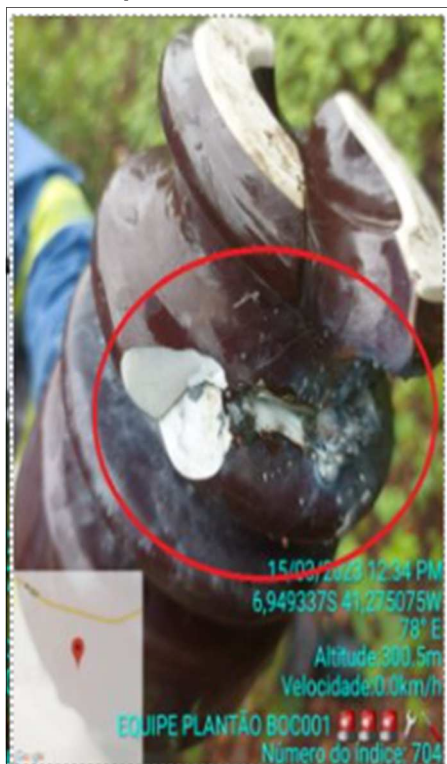
Foto 11– Isolador danificado por descarga atmosférica, conforme indicado.
