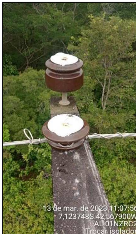
Foto 6 – Isolador danificado por árvore na rede.
