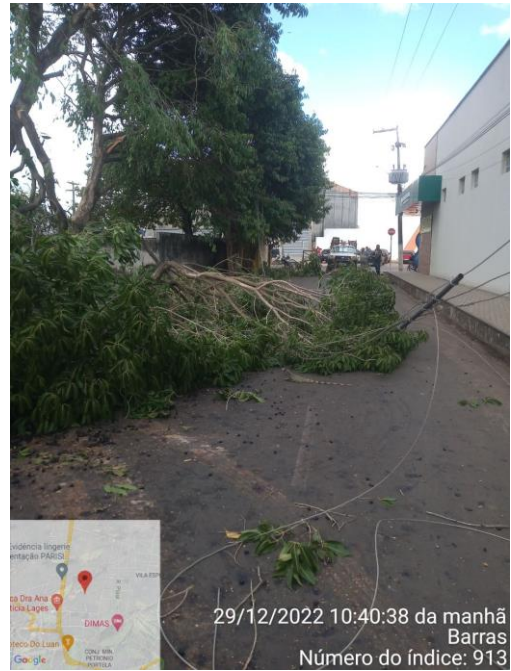
Foto – Cabo de MT Partido e sob a Fiação
