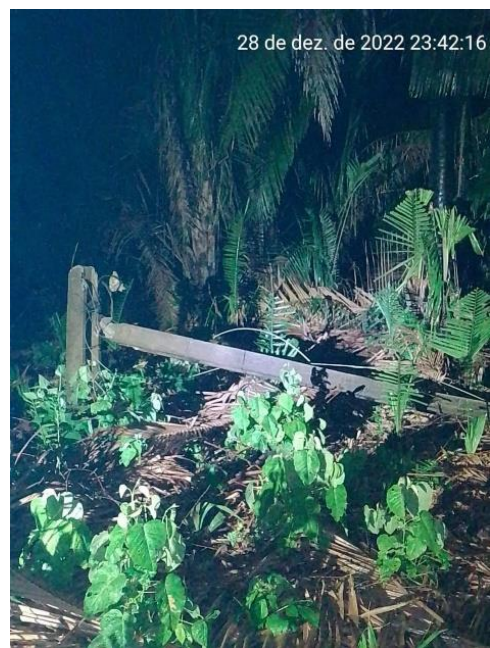
Foto – Poste quebrado
