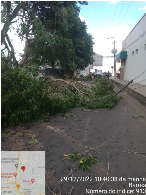
Foto – Cabo de MT Partido e sob a Fiação
