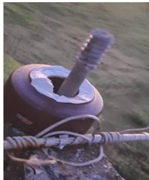
Foto – Isolador Quebrado devido à Descarga
