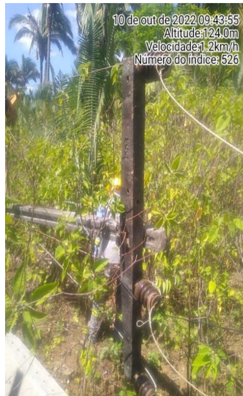
Foto – Poste Quebrado
