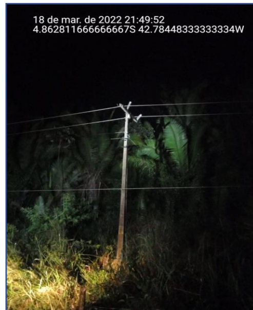
Foto – Danos causados pelas chuvas.
