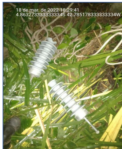
Foto – Isoladores danificados pela vegetação.
