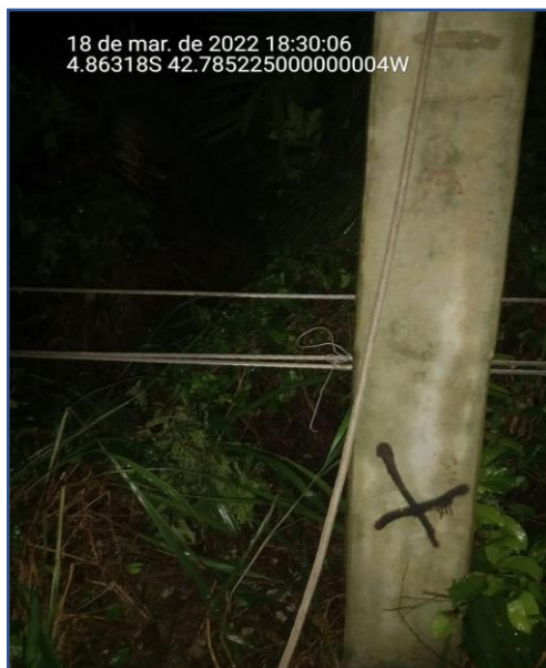
Foto – Danos causados pelas chuvas.
