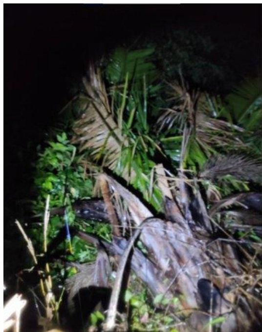
Foto – Cabo partido causada por arvore na rede em decorrências as fortes chuvas.
