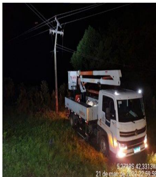
Foto – poste danificado causado por rompimento de cabo a partir de arvore na rede em decorrências as fortes chuvas.
