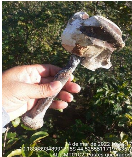
Foto – Isolador danificado por descarga atmosférica
