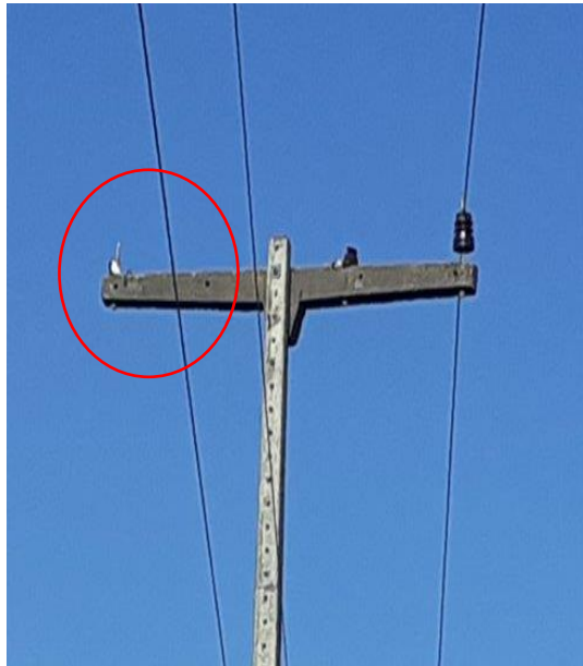
Foto – Isolador danificado por descarga atmosférica
