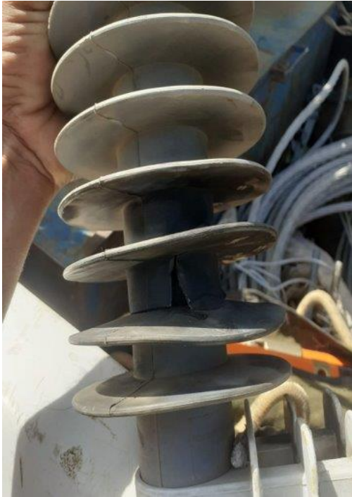
Foto – Elo fusivel danificado
