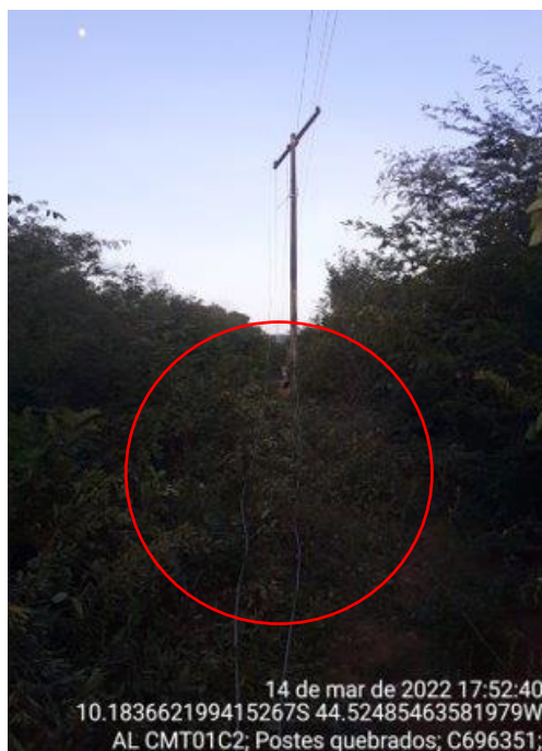
Foto – Cabo partido e isolador danificado
