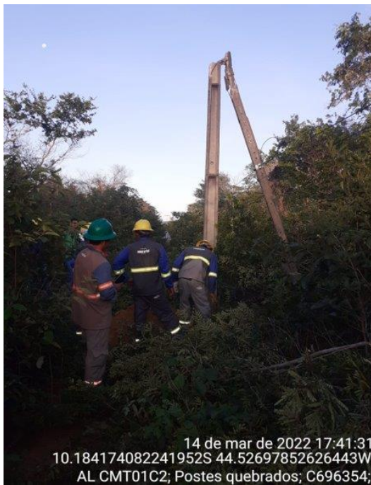
Foto – Poste danificado.
