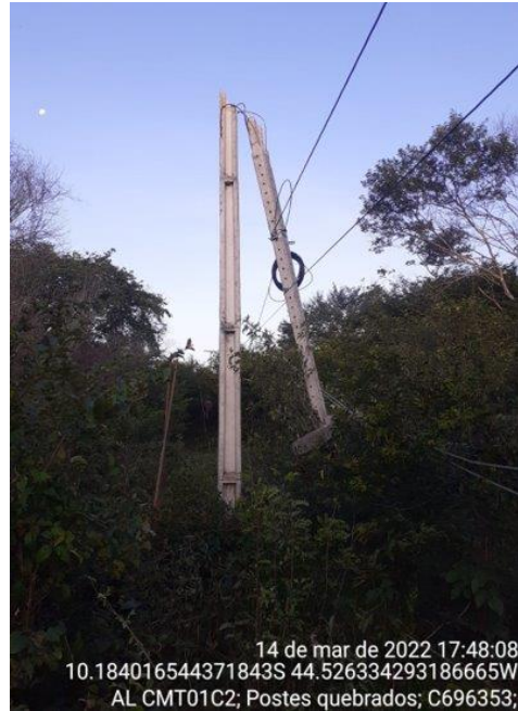
Foto – Poste danificado
