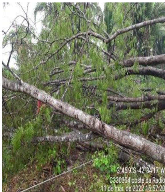
Foto – Cabo partido causada por arvore na rede em decorrências as fortes chuvas.
