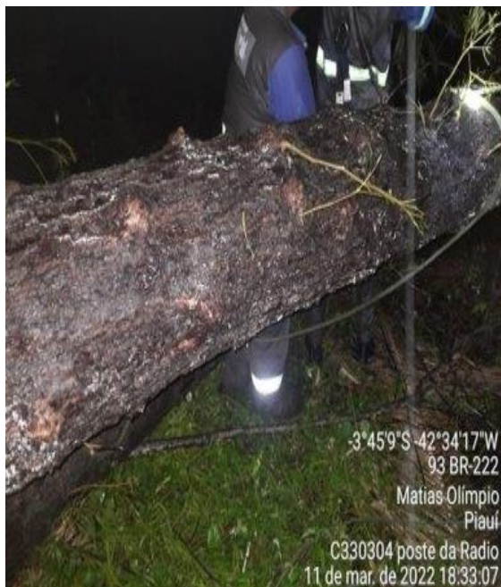
Foto – Cabo partido causada por arvore na rede em decorrências as fortes chuvas.
