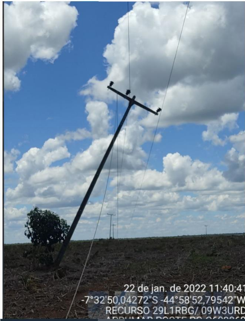
Vão de rede MT rompido e poste tombado devido o período chuvoso.
